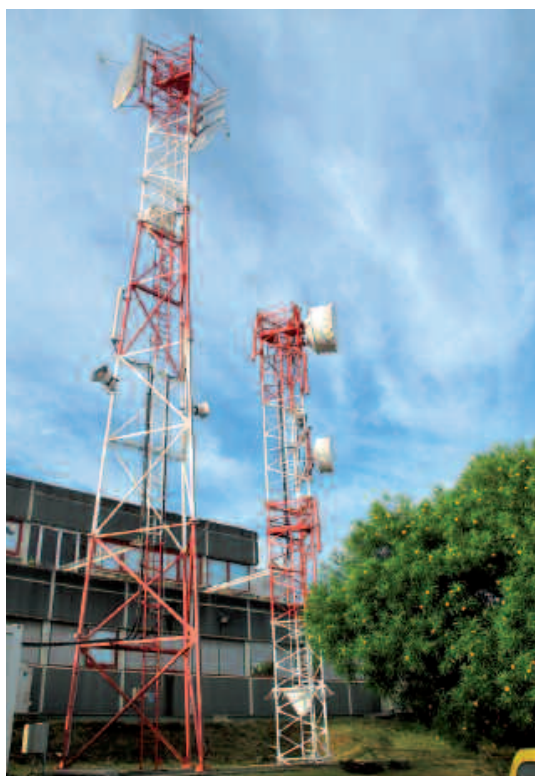
Sur le site Hotuarea, acheminement du trafic par faisceaux hertziens via le mont Marau pour les transmissions avec Moorea et les Iles sous le Vent
